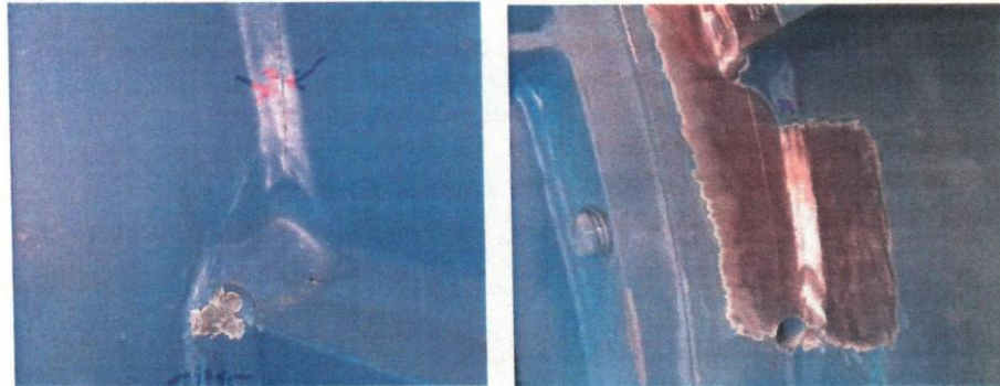
Fisuras antes y después de limpieza por cepillado de F10-EDG301A
